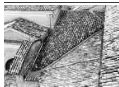
42. Fotografia dello stato dei tetti del Duomo prima della risistemazione del 1964. Da notare a sinistra il frontone seicentesco della cappella di San Carlo distrutto in quell'occasione.
